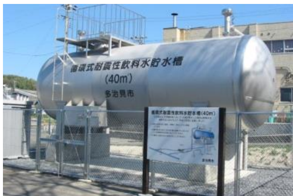
耐震性貯水槽
