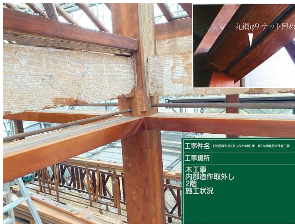
耐震構造（手すりや欄間にボルトを通した補強）
